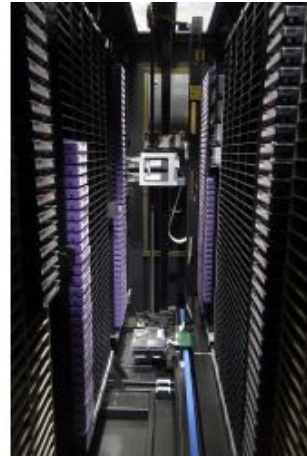
Innenansicht der Taperoboter Foto: All for One Steeb
