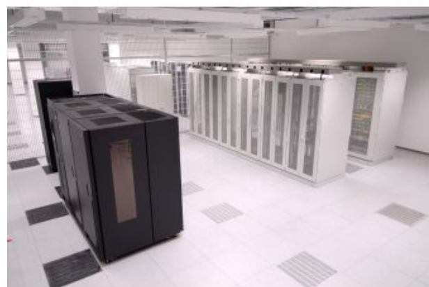
Server im Herz des Rechenzentrums Foto: All for One Steeb
