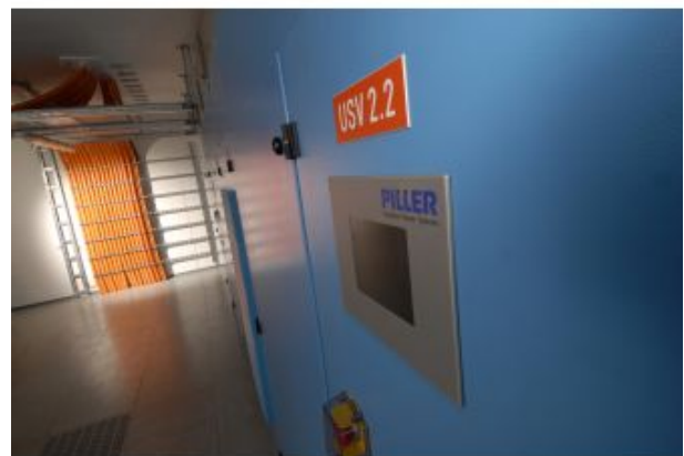
Seitenansicht der USV-Anlage Foto: All for One Steeb
