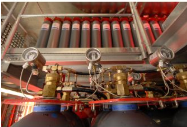
Die Gaslöschanlage Foto: All for One Steeb
