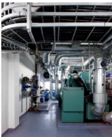
Ein Streifzug durch das Rechenzentrum der All for One Steeb in Frankfurt Foto: All for One Steeb
