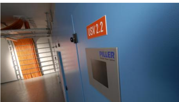
Seitenansicht der USV-Anlage
